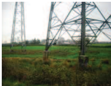
Pylônes sur le terrain
