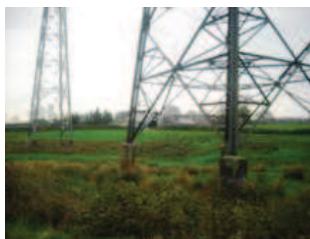
Pylônes sur le terrain
